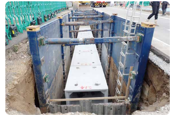
雨水管渠(鶴沼古市場町)
