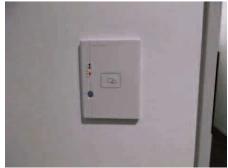
事例：ICカード認証（甲府市）
