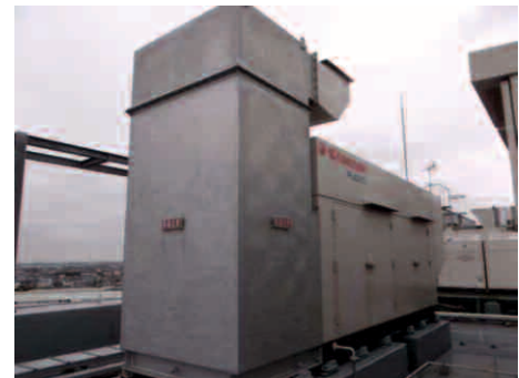
事例：自家発電装置（刈谷市）
